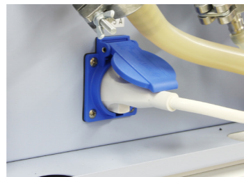
Steckdose zum Anschluss und Steuerung der Vakuumpumpe
