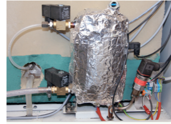
Generador de vapor, Control de humedad
